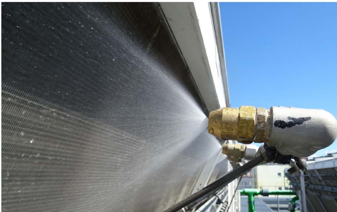
Abbildung 1: Kälteversorgung in der Industrie stellt einen erheblichen Anteil am Energieverbrauch
